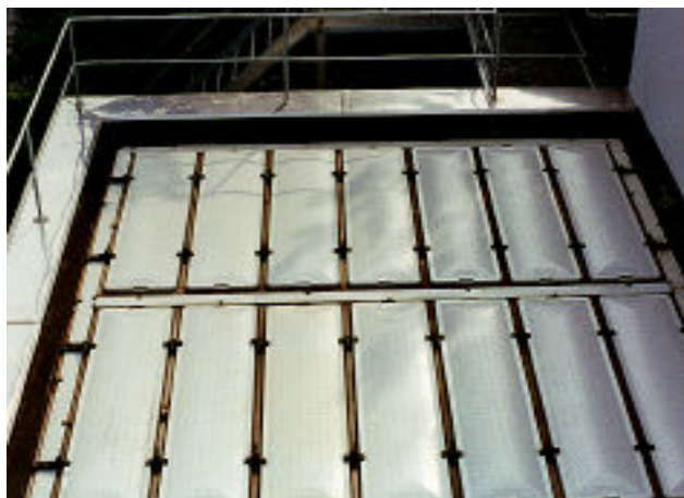
Couverture du réacteur, Ditzler S.A., Möhlin
