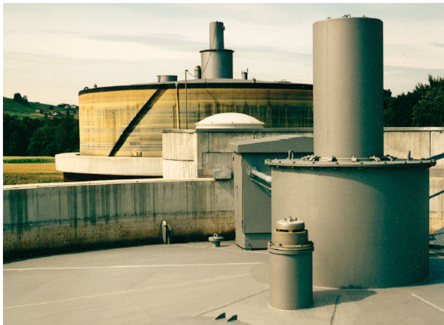
Installation de digestion de la Verna (VD). Des installations de digestion ALPHA-PFT sont en service dans le monde entier. En Suisse, 110 cloches flottantes et gazomètres sont en activité
