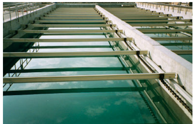
Bassins de décantation secondaire à courant longitudinal, STEP de Thoune (BE)
