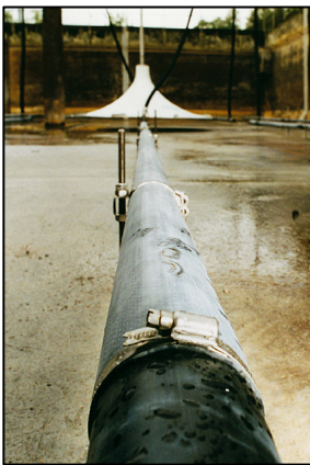
Emplacement de l'agitateur HYPERCLASSIC® au-dessus du diffuseur d'air à membrane RK à fines bulles
