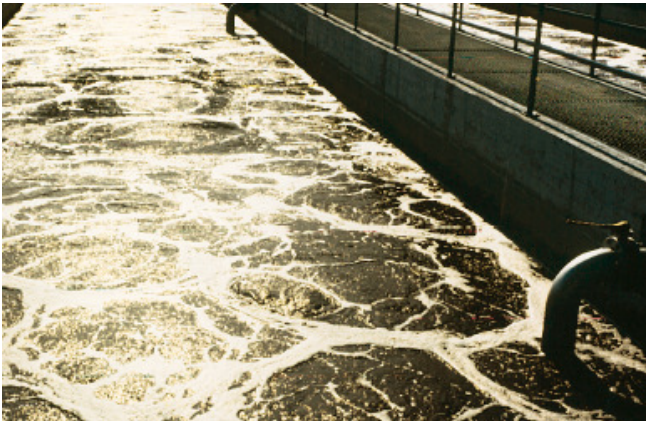
Bassin d'aération avec diffuseurs ALPHA-IFU
