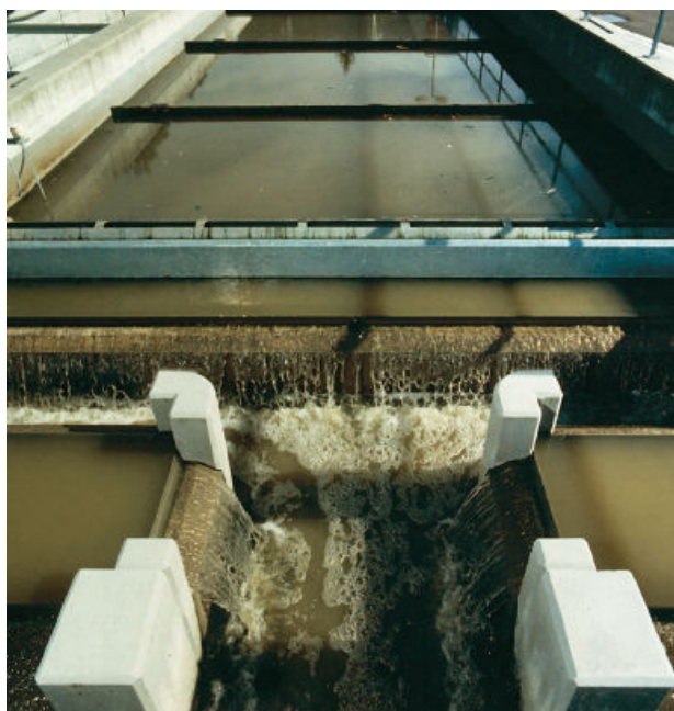
Déversoir d'un décanteur primaire en arrière-plan. Installation pour la récupération des flottants et racleurs
