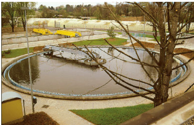
Bassin de décantation circulaire
