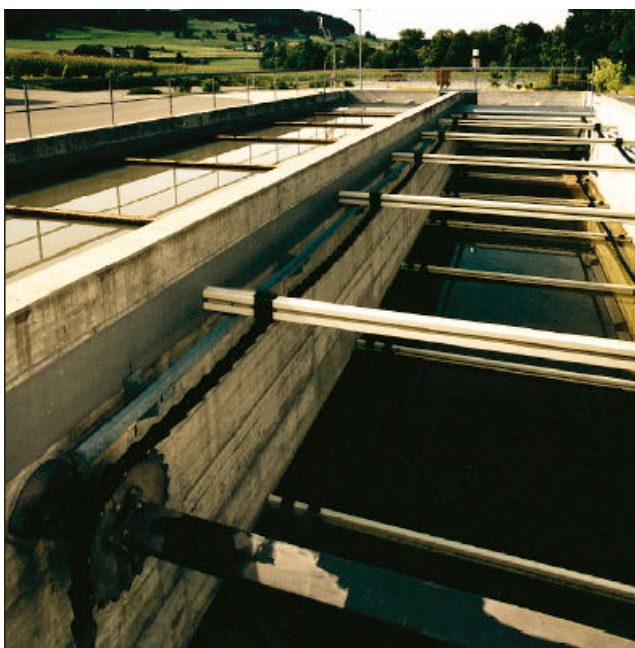
Racleur de boues dans un bassin de décantation primaire rectangulaire
